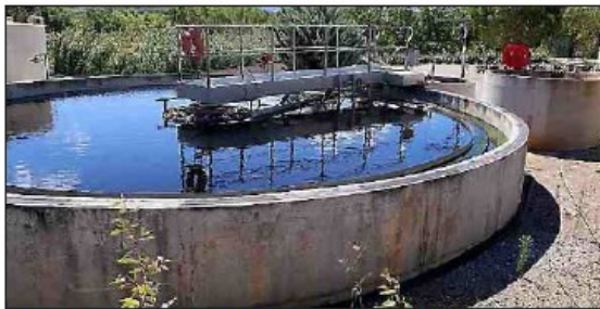
▶ Difficile actuellement de remplir les bassins à Durban.
